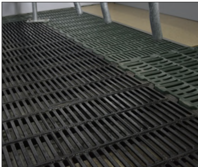
полы в родильной клетке на основе пластиковых и бетонных решёток
